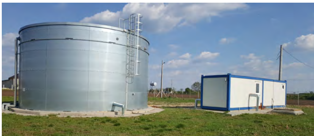
Foto nr. 7 – Gospodărie sistem alimentare cu apă, comuna Măgura
