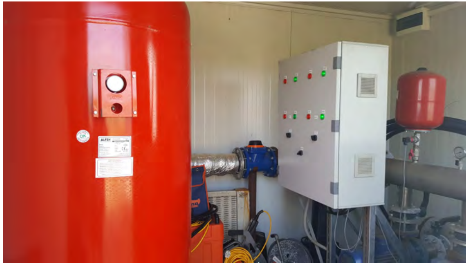
Foto nr. 8 – Cameră automatizare sistem alimentare cu apă, comuna Măgura
